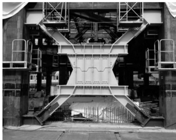
図4. JPタワー名古屋(2015年11月完成予定、施工:竹中工務店)に実装された新合金制振ダンパー
