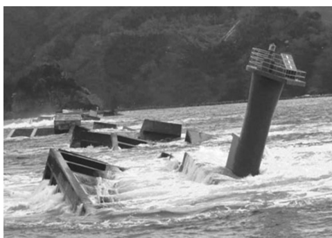
図1 釜石防波堤の被災状況
